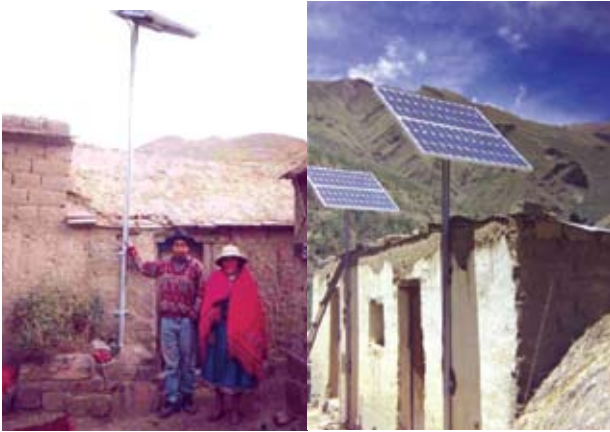
Electrificación mediante paneles solares en viviendas rurales.
