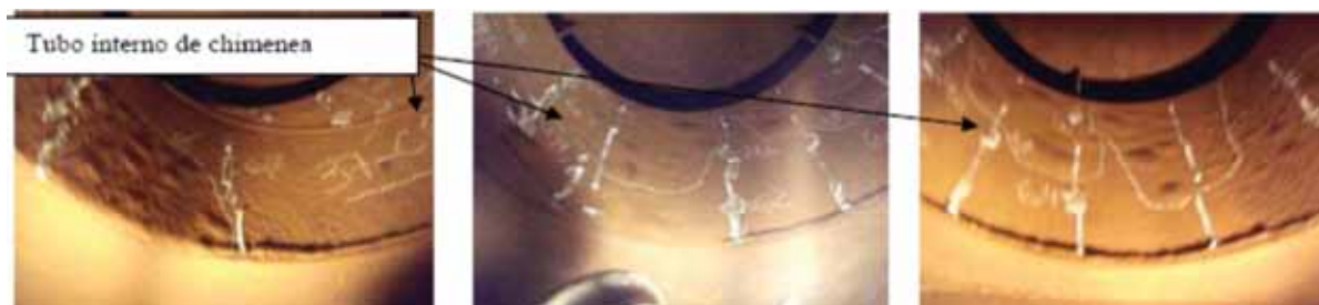
Figura 3. Ampollamiento por hidrógeno en el conducto de transición interno de la columna Scrubber.
