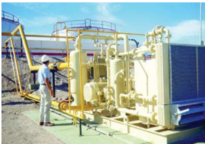
Figura 7. URV instalada en batería de tanques
