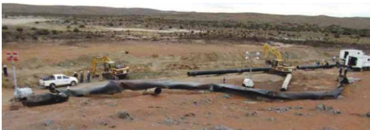
Figura 1. Cañería afectada por la falla. Zona de falla.
