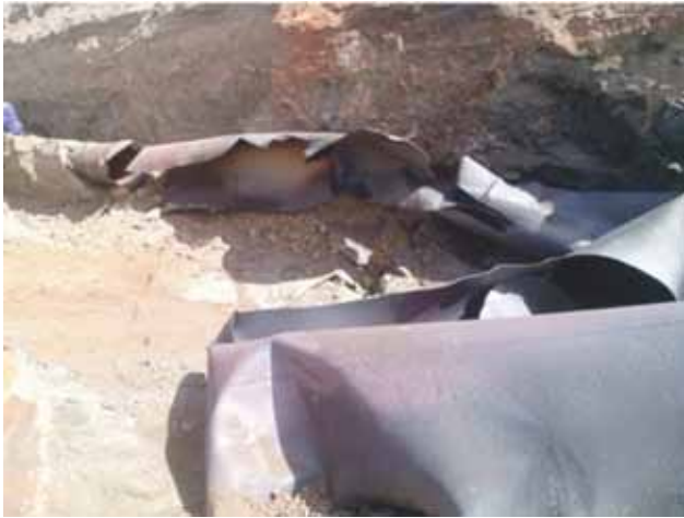
Figura 3. Estado de las chapas luego de la ignición. Estado del material.
