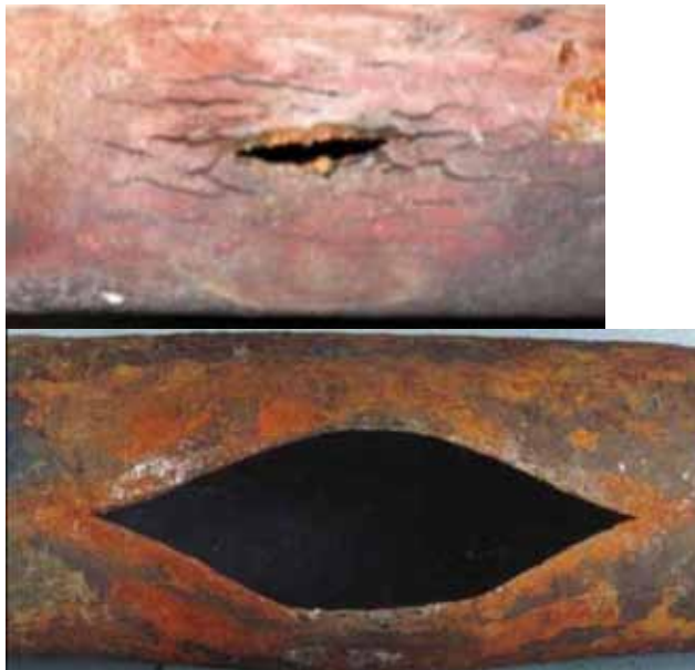
Figura 3. Daños en tubos de hornos provocados por sobrecalentamiento.
